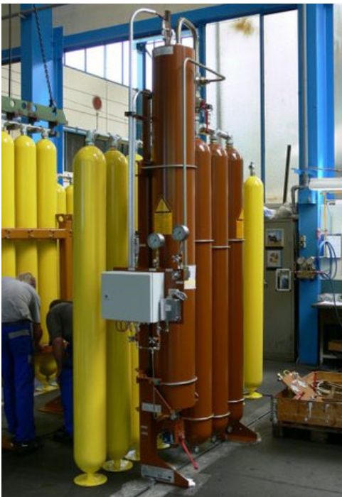
OLAER/BSD Kolbenspeicherstationen als Energie- reserve zur Regulierung von Francisturbinen Anlage Sisteron France Andritz Hydro AG, Kriens
