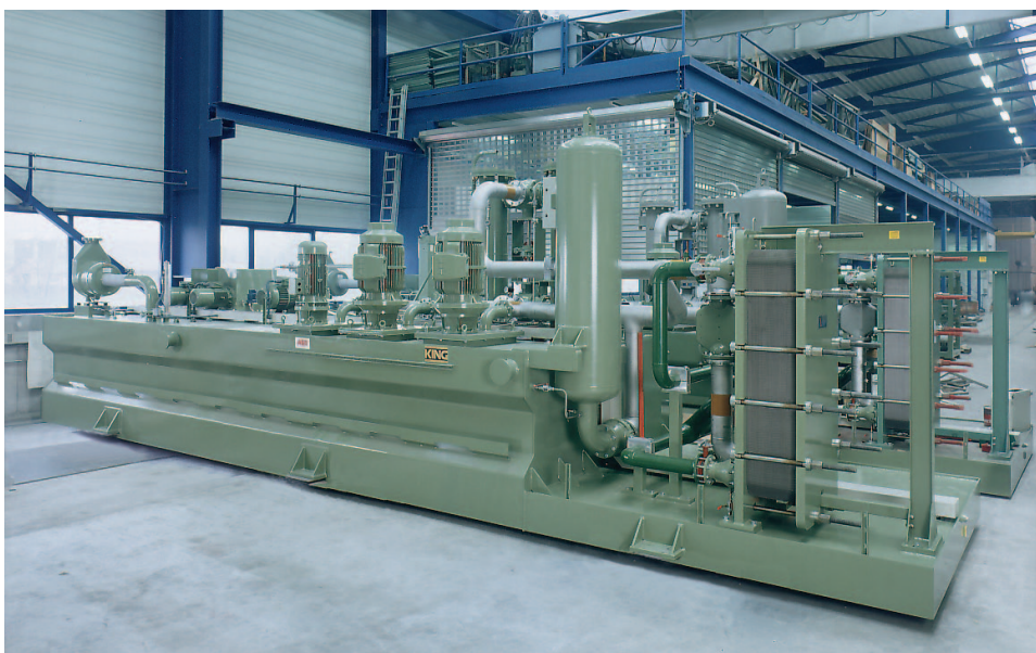
Hilfsbetriebsblock der Gasturbine zur Schmierölversorgung Alstom, Baden
